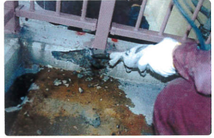
固定部の水の蓄積、鋼材腐食
