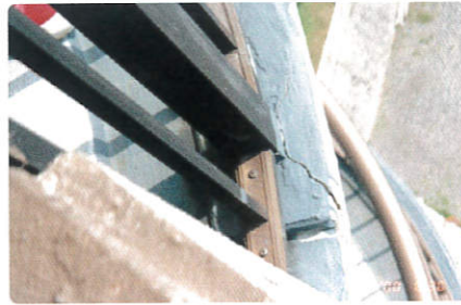
ひび割れ、浮き
