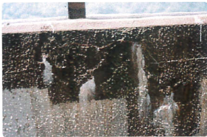
ひび割れ、エフロレッセンス
